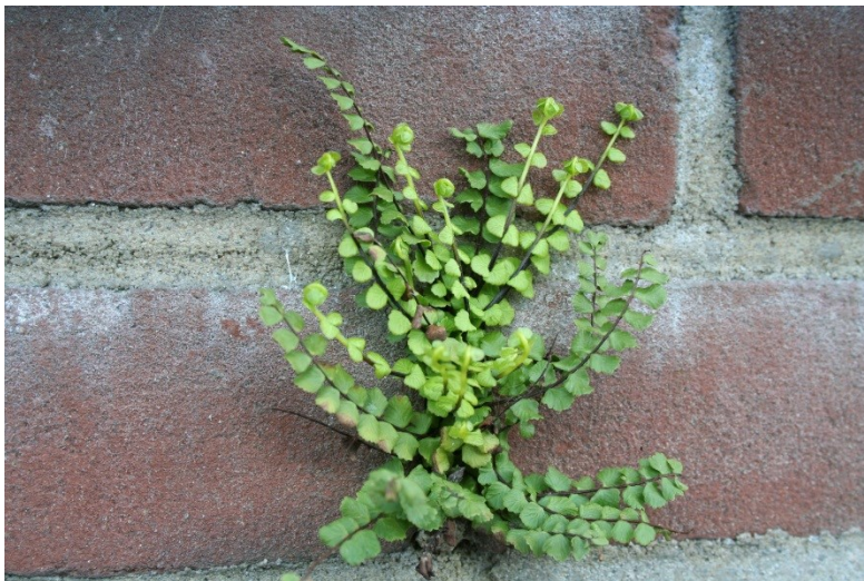
Afbeelding 1: Steenbreekvaren in de muur bij de Nieuwe kade
